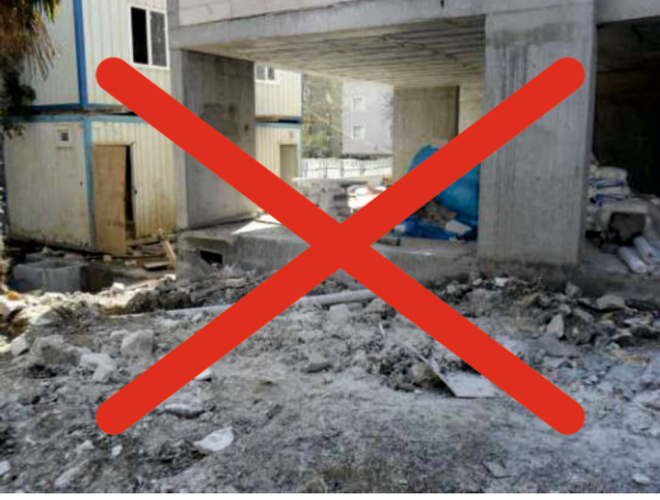
İskele Kurulmaya Uygun Olmayan Zemin
